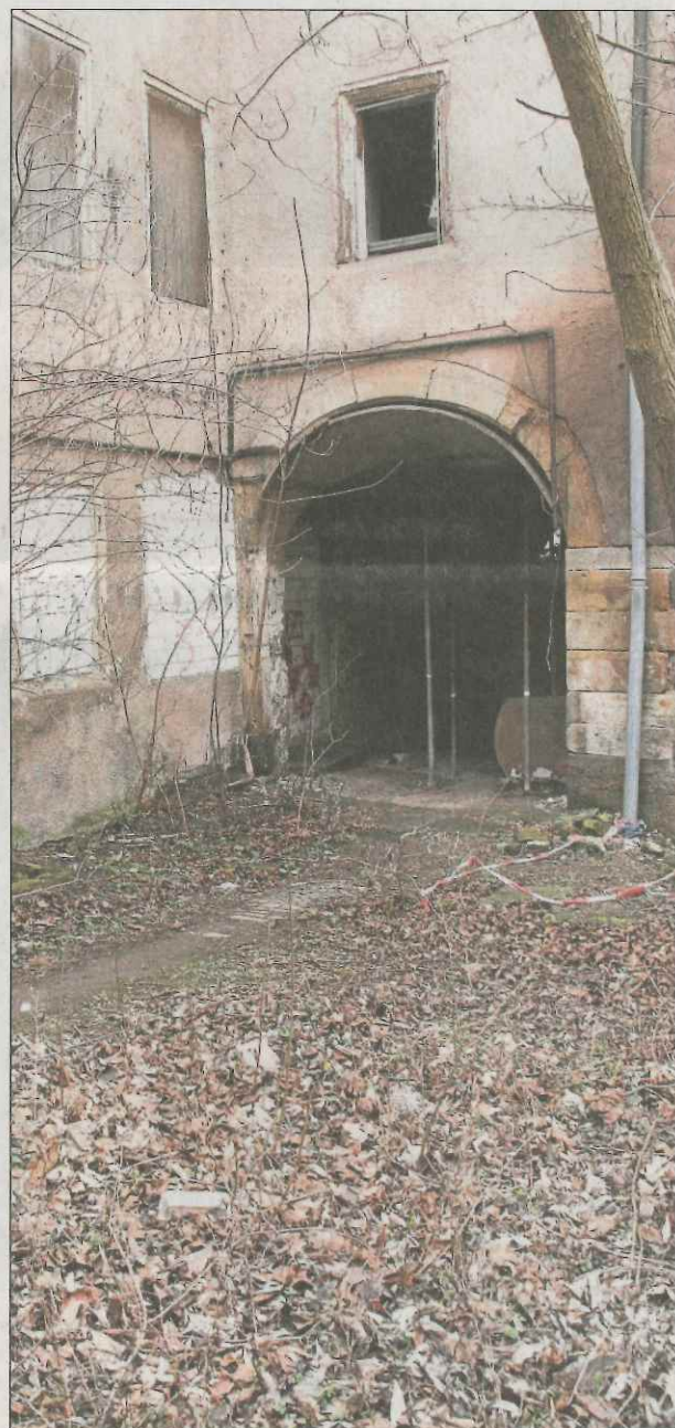
Die Rückseite des Amtshauses offenbart ein kleines Rundbogenportal mit Abstützungen wegen Einsturzgefahr.
